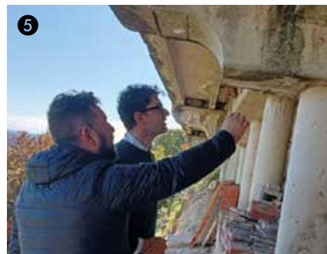
5 I sopralluoghi tenutisi in via Belvedere per la messa in sicurezza della stessa. Le criticità riguardano principalmente il tratto compreso tra l'imbocco del sentiero Oliva e l'intersezione con via Donzelli. (Foto: Giornale di Merate)
